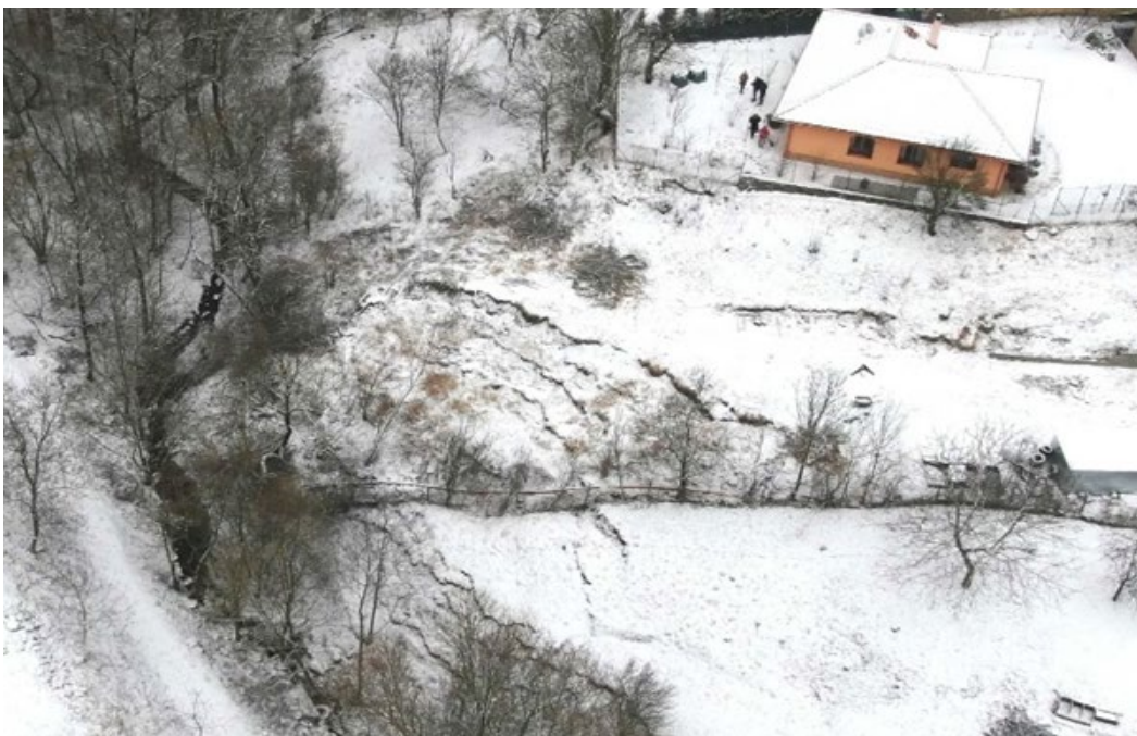
Stupňovité aktívne šmykové plochy pod rodinným domom č. 116 na lokalite Ruská Nová Ves 2 (pohľad z dronu, zdroj: SVP, š. p.)
