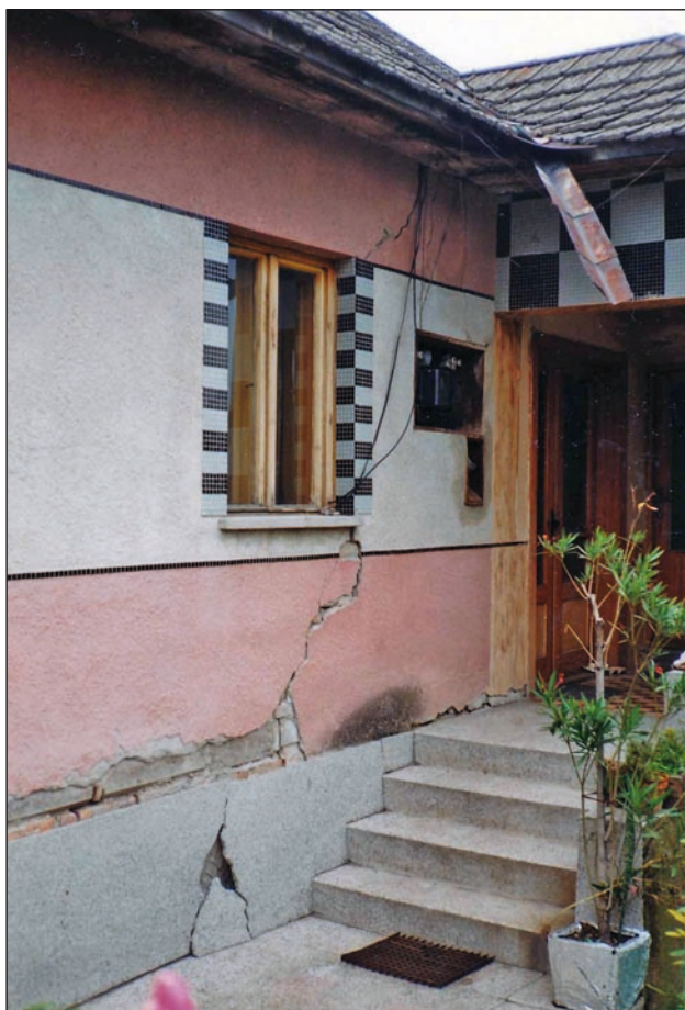
Obr. 3. Silné porušenie rodinného domu č. 492 v obci Kamenín po prístavbe, chýba odkvap (foto Klukanová).
