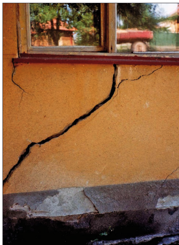
Obr. 4. Trhliny do 10 cm široké na objekte v obci Pohronský Ruskov, Kostolná ul. č. 8 boli spôsobené zatekaním vody pod základy domu, príčinou bol porušený odkvap (foto Klukanová).
