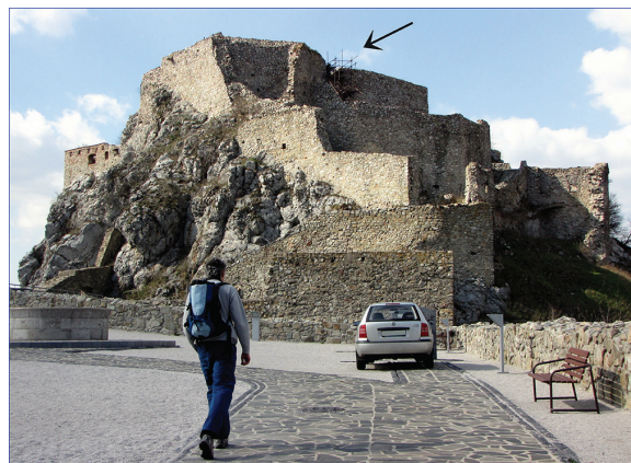
Obr. 1. Lokalizácia abráznej pukliny pod citadelou (foto A. Zlinská).
